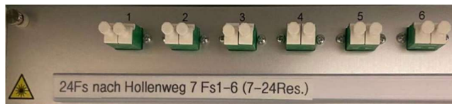
Glasfaser-Panel an der Dorfstrasse, mit Reserve Leitungen
