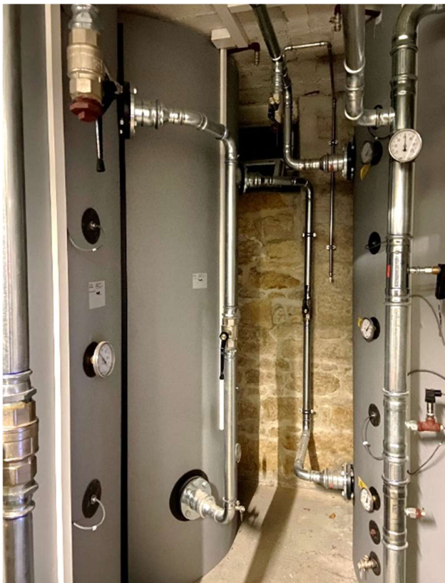
Puffer-Speicher im Schulhaus - die Leitungen sind noch unisoliert
