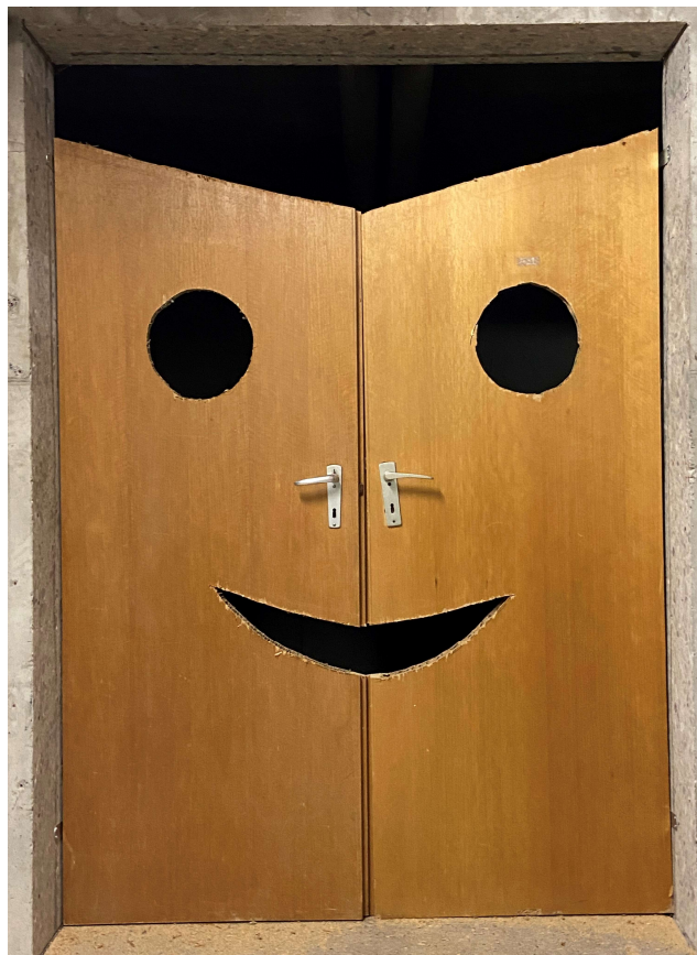
Provisorischer Lüftungszugang Zentrale Dorfstrasse, Modell "Happy"
