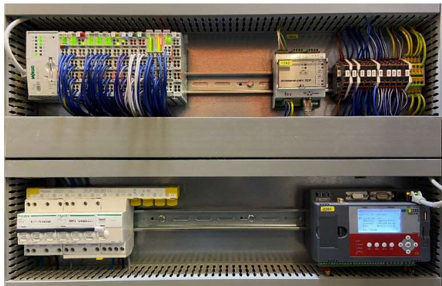
Teil der SPS-Steuerung in den Schaltschränken
